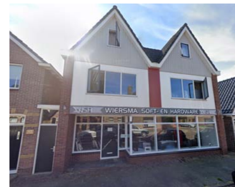
Gevelbrede reclame borden brengen een knip aan tussen plint en gevel 1e verdieping
