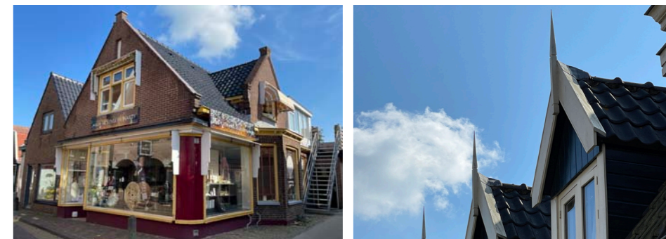
Een aantal fraaie gevels zou baat kunnen hebben bij het verwijderen van enkele niet oorspronkelijke elementen, zoals in dit geval de later aangebrachte omkasting van (inmiddels niet meer aanwezige) zonwering of de reclame borden voor de oude dakgoot. De onverzadigde kleuren lijken wel goed te passen bij het pand.
